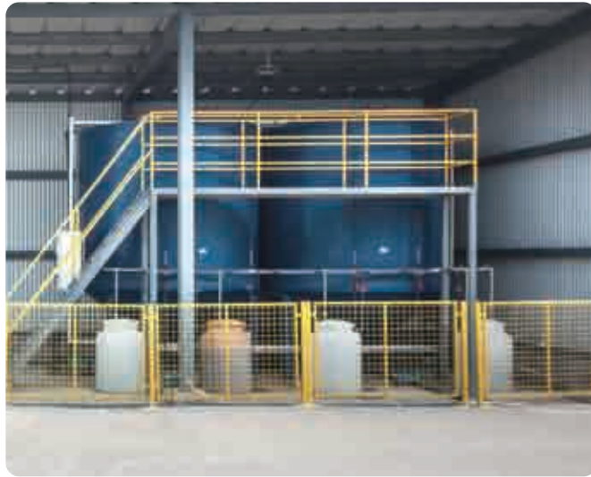
■ 喷塑污水预处理池
